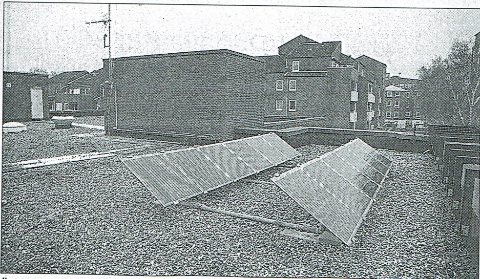
Über den Dächern der Stadt: So sieht die derzeitige Photovoltaik-Anlage auf dem Dach des Wedeler Rathauses aus.
